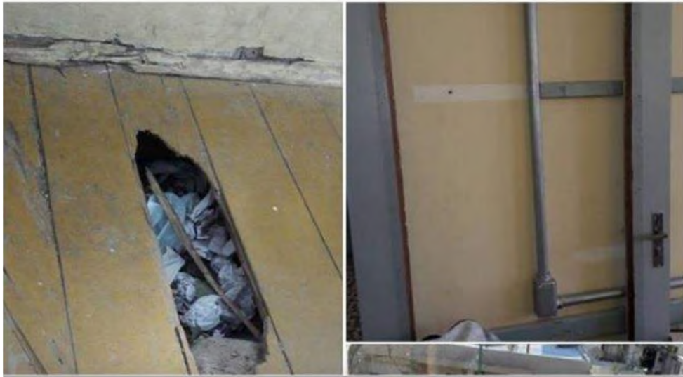
Figura 1: Reportagem sobre problemas estruturais na escola. Fonte: Bilac News.
